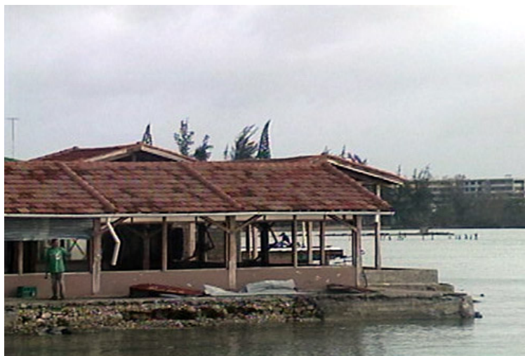
Figura 2. Afectaciones en el restaurante Covadonga asociadas al paso del huracán Michelle por Cienfuegos.
